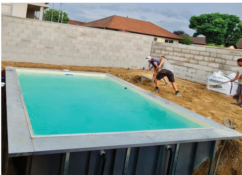
Mise en eau de la piscine - rempliement autour de la structure - produit breveté et homologué par le bureau de contrôle Socotec.
